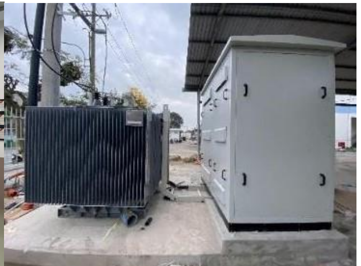
TRẠM BIẾN THÉ 3000 KVA
